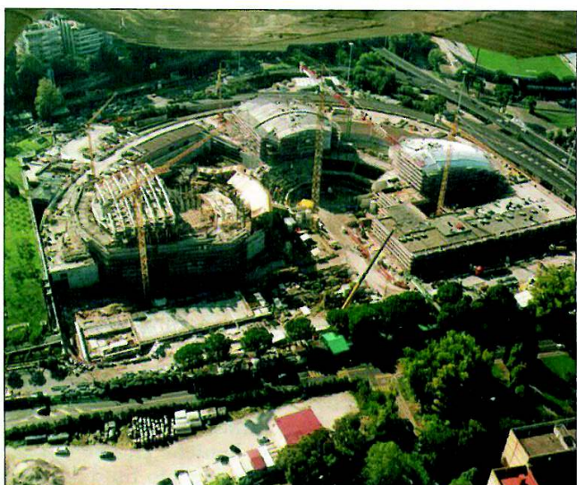
4. L'intervento prevede la realizzazione di un grande volume edificato - l'edificio anulare - che svolge funzione di basamento dell'intero sistema e dal quale spiccano le tre "casse armoniche" che costituiscono le sale da concerto.
