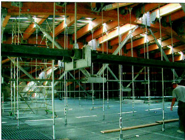
11. All'intradosso della copertura, agganciato in sospensione alla struttura in lamellare, il progettista ha predisposto un grigliato tecnico al quale verranno applicati gli impianti.
