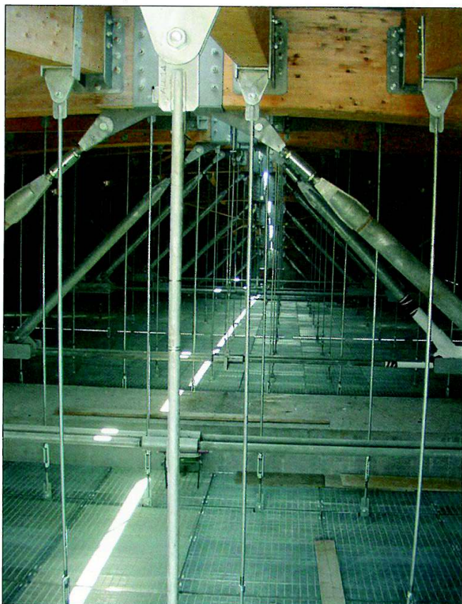
12. Al grigliato tecnico, ancorato tramite tiranti alla struttura lignea, verrà ancorata la controsoffittatura in pannelli di legno delle sale da concerto.
