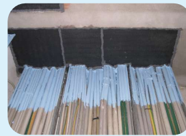
protezione cavi e passacavi
