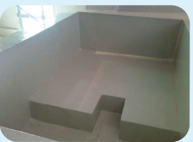
vasche di contenimento
