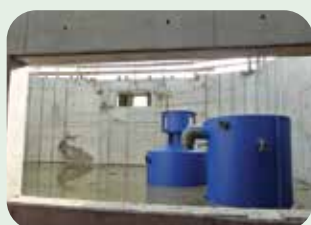
Protezione vasche di decantazione
