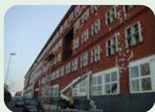
ripristino facciate ammalorate
