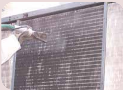
entretien d'installations d'air conditionné
