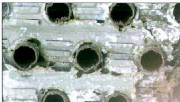
FIG. 1 Corrosione di coil Cu-Al. Cu-Al coil corrosion.
