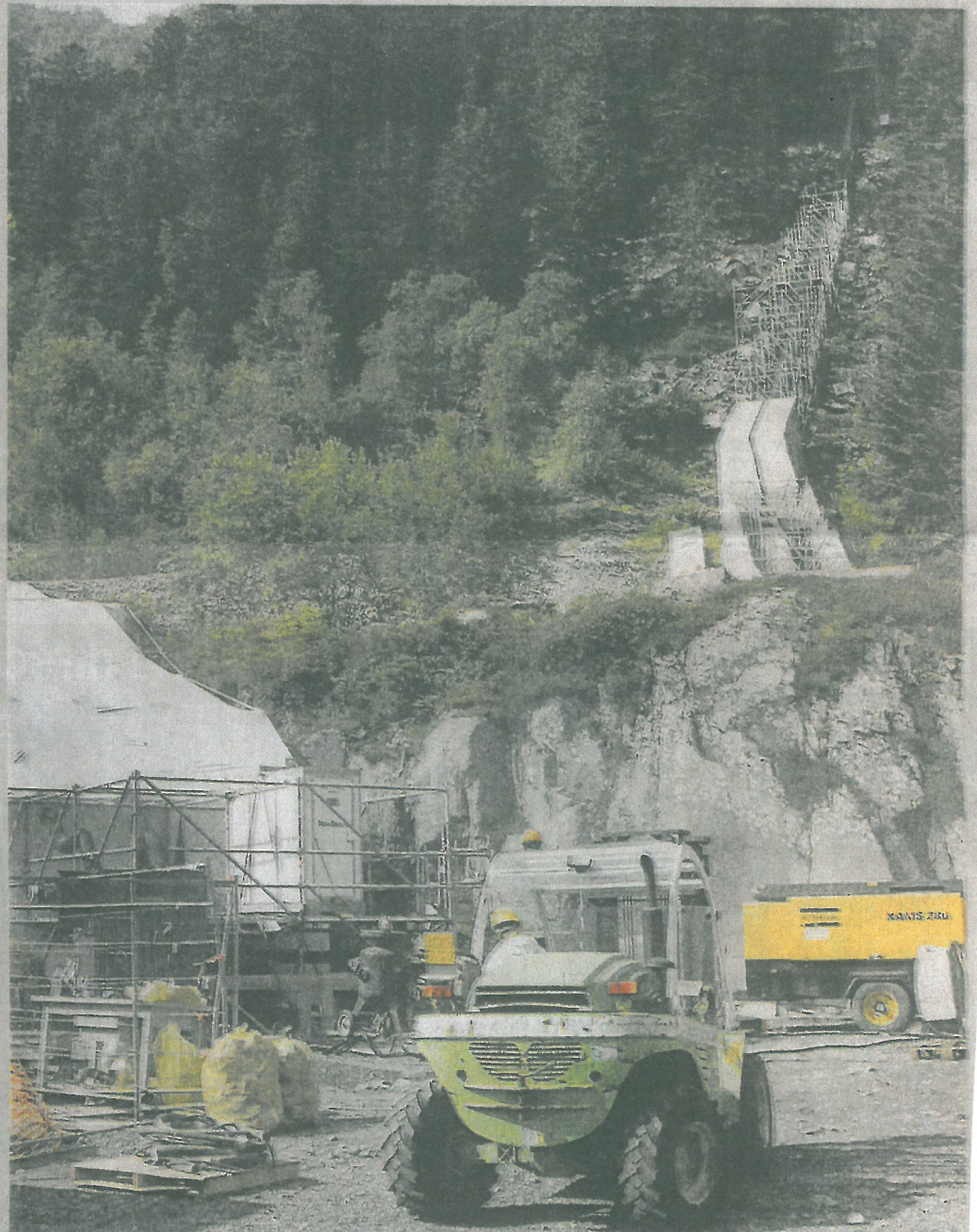
À gauche, l'entretien de la conduite de Suyen et de face, celle qui arrive du barrage de Migouélou. / Photo J.C.
