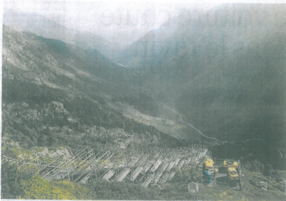
Un impressionnant échafaudage entoure la conduite forcée du barrage de Migouélou. /Photo DDM, Jean Guyot.
