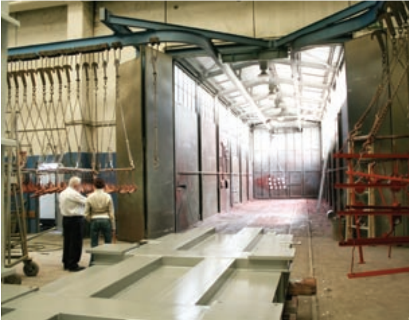
Fig. 9 - La cabina di verniciatura aperta per la movimentazione verso l'esterno con trasportatori dei pezzi verniciati: a destra e a sinistra di figura
